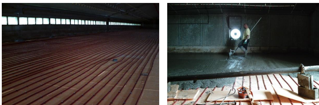
Figure 1 : Exemple d'installation d'échangeur thermique (source ITAVI)
